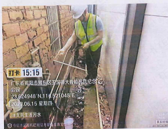
3#支洞生活污水
