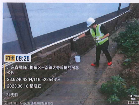
3# 支洞隧道洞口排水
