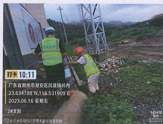
2# 支洞隧道洞口排水
