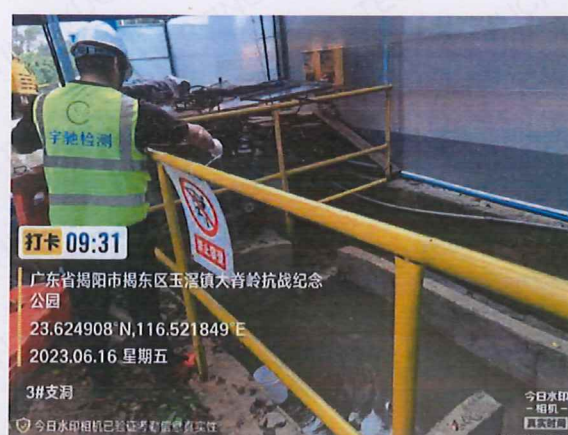
3#支洞生产废水
